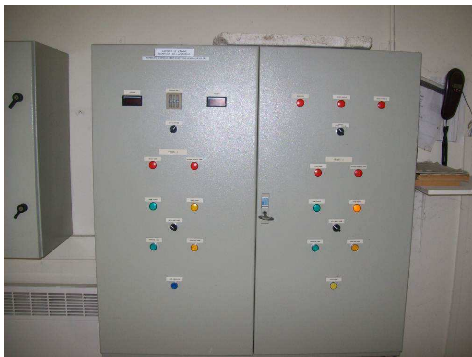
Figure 27 : Armoire de contrôle des vannes
