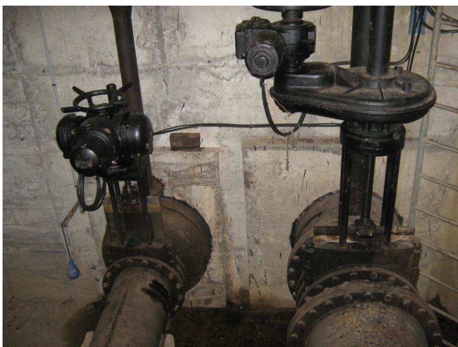
Figure 25 : Vannes de restitution des lâchers et du débit réservé
