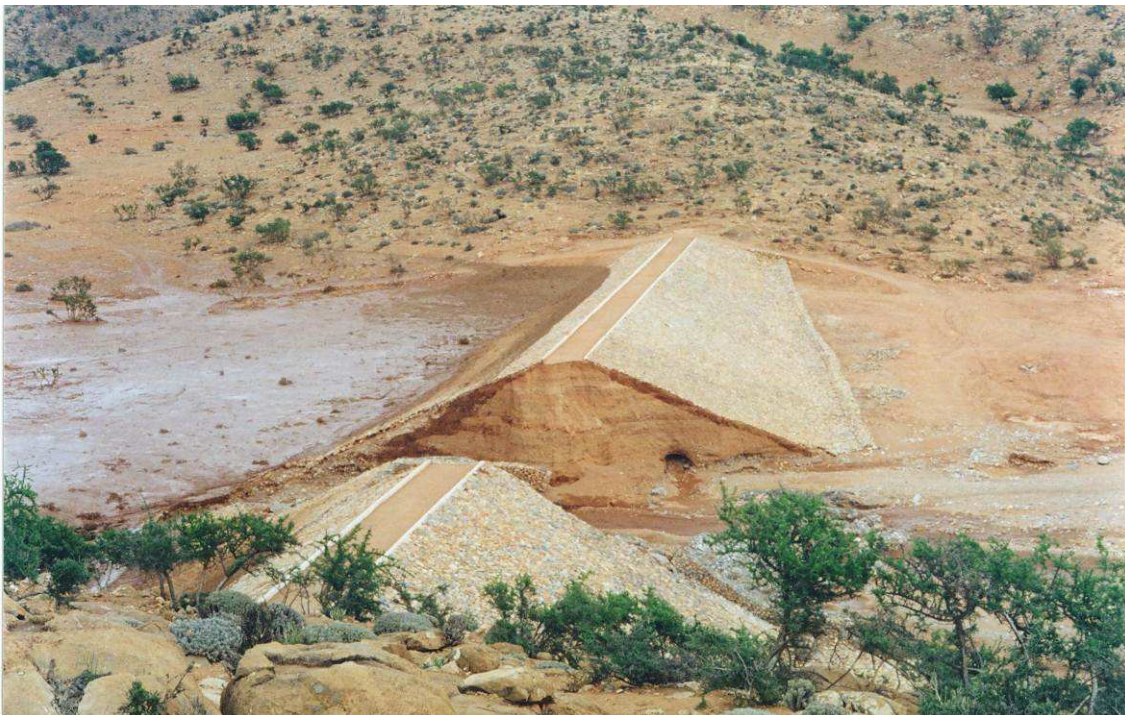
Figure 10 : Brèche dans un barrage au Maroc (photo FM-CACG)
