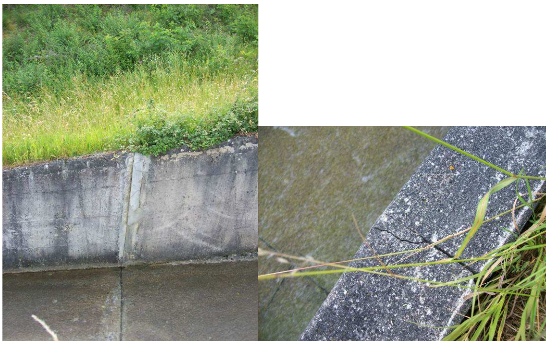
Figure 18 : Rares désordres sur l'évacuateur principal de crues
